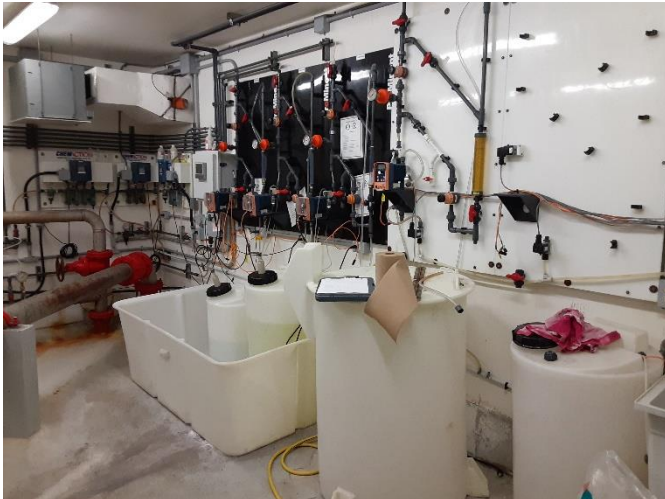
Photographie 3 : Installations de production d'eau potable
